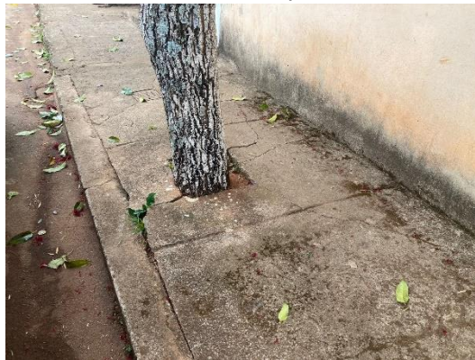
Figura 04: Vista da calçada estreita e das rachaduras causada pelas raízes.
