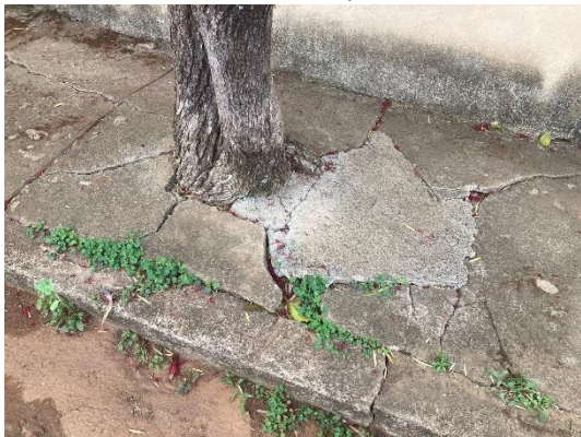
Figura 03: Vista da calçada e das rachaduras causada pelas raízes.
